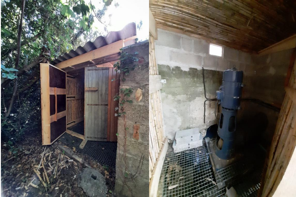
Photo 18: Aménagement phonique de la station de pompage du Petit Badon (P. Rocarpin, 2023)
